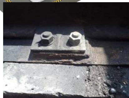
Schweißnähte der Schienenzange beginnen zu korrodieren.
