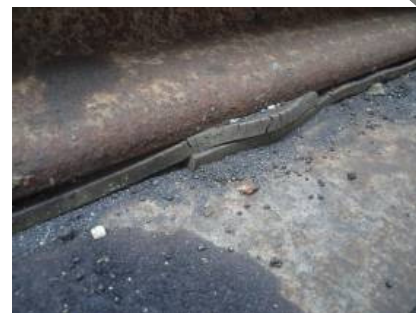
Zwischenlage ist nicht korrekt installiert.
